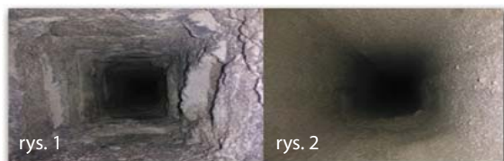
Komin po latach użytkowania posiadający nieszczelności, rys. 1 Wnętrze kominu po użyciu masy uszczelniającej JAWAR, rys. 2
